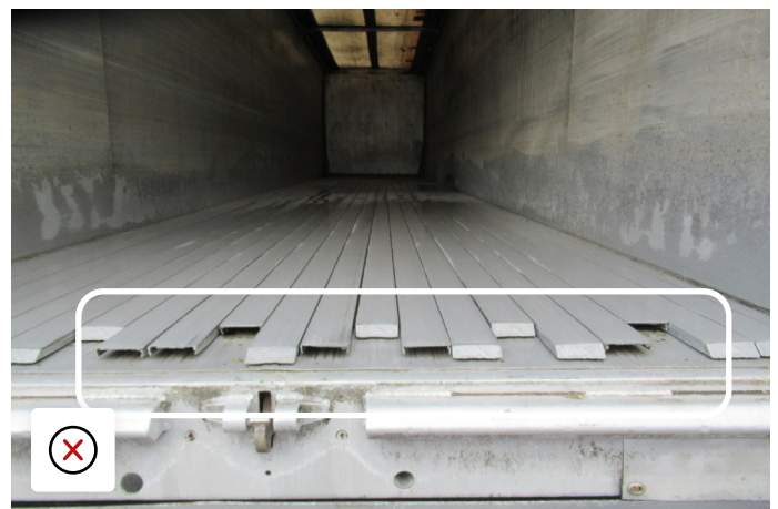
profilkanter saknas - gods kan falla under golvet
