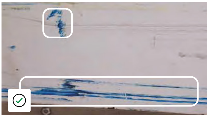
Glasfiberpanel repad av pallar, men repan har ej penetrerat det skyddande täcksiktet.
