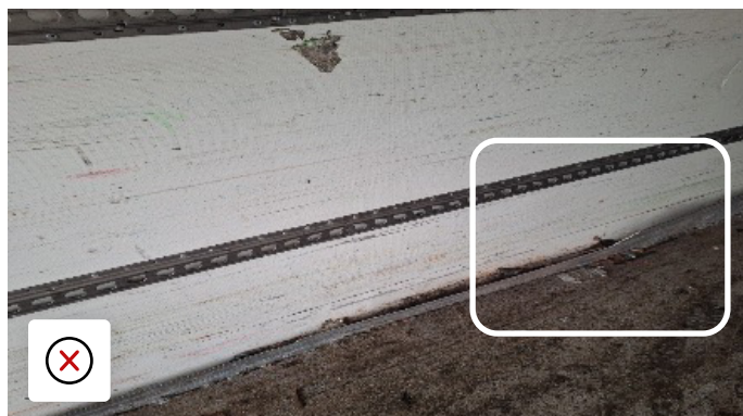
Sparkskydd skadat och avdraget från panelen.
