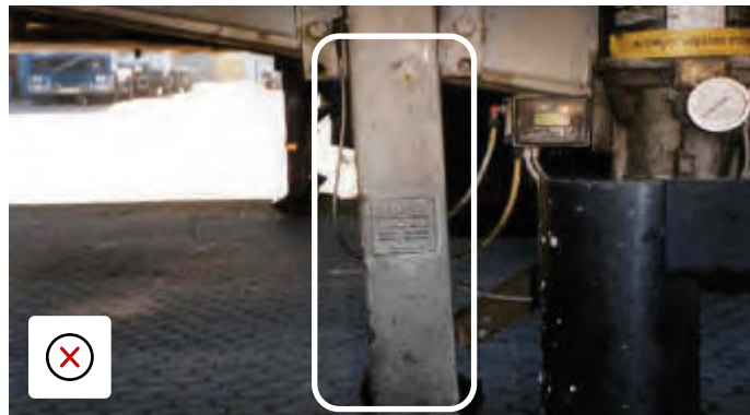
Stödbenet böjt och måste bytas ut
