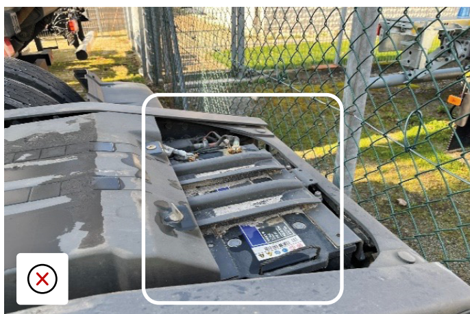
Batterihöljet saknas - batteriet utsätts för väder och vind
