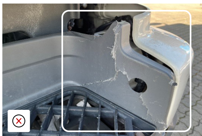
Stegets stödkonstruktion är inte säker på grund av påverkan
