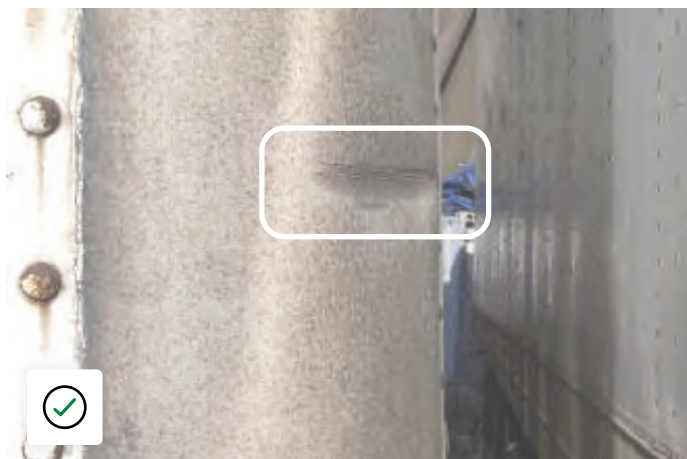
Hörnstolpe skadad av kollisioner, buckliga, men ej penetrerade.
