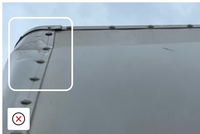
Hörnstolpe skadad av kollisioner där ytfärgen skavts av.
