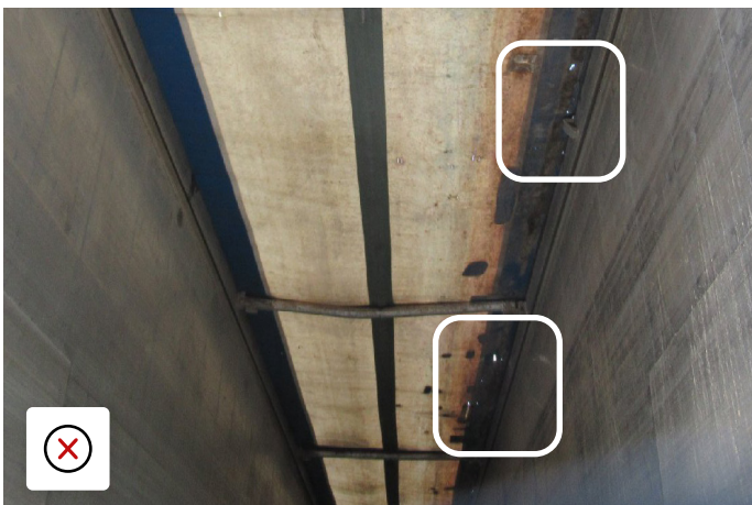
Hål i kåpan - kräver reparation
