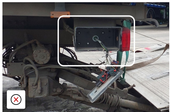
Extern brytare sönderslagen - behöver bytas ut
